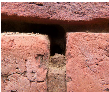
Hier siedeln Wildbienen, auch Fledermäuse nutzen Spalten, die nur daumendick sein müssen, als Tagesquartier.
